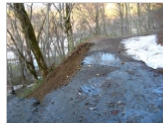
路肩が崩壊した箇所あり
